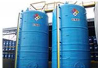
Trasvase y descarga en estanques
